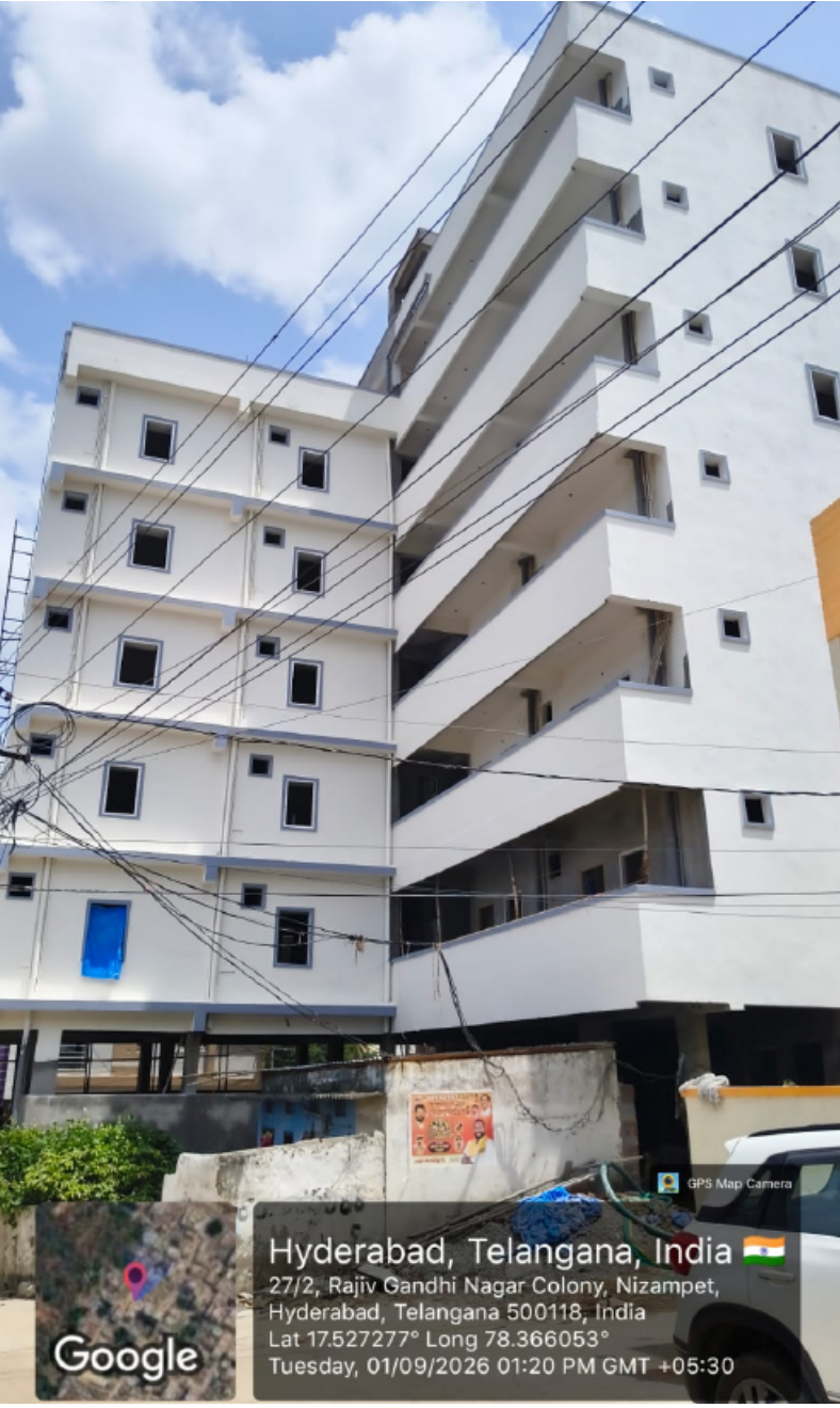
-నోటీసులు.. డ్రిల్లింగ్‌లు.. ఆపై మళ్లీ యథావిధిగా నిర్మాణాలు -కుత్బుల్లాపూర్‌లో భవన నిర్మాణాలపై అధికారుల పర్యవేక్షణ ఎక్కడ? ప్రజల భద్రతకు బాధ్యత ఎవరిది?
